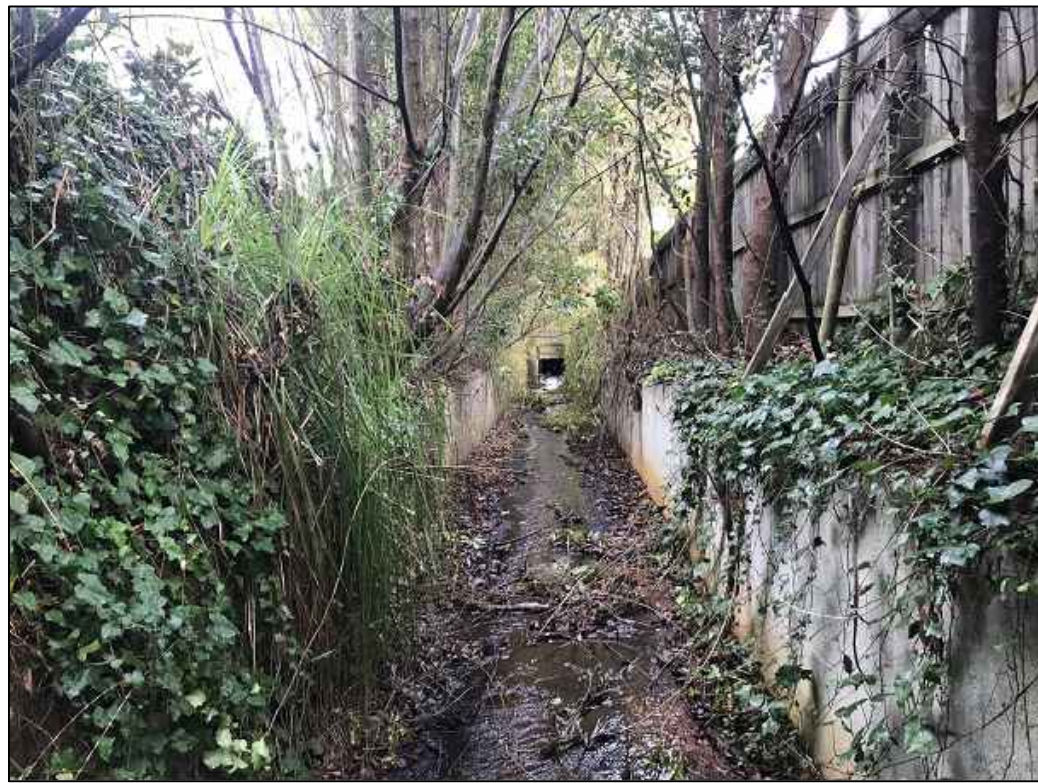
PHOTO E1 - DOWNSTREAM
